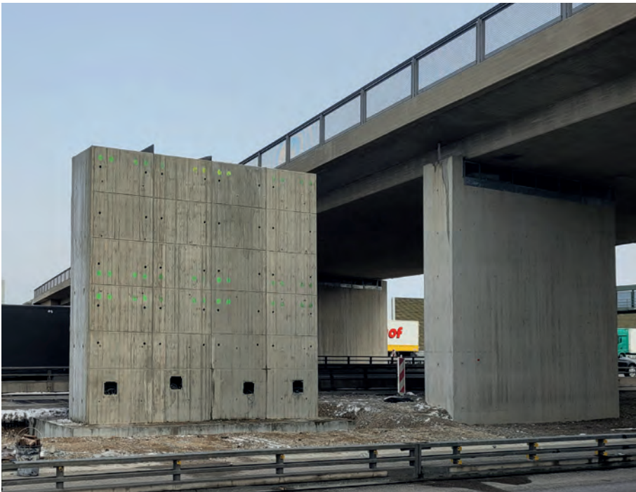
Demonstratorbauteil an der A99 zur Bewertung der Dauerhaftigkeit von Stahlbeton. Gemeinsame Forschung der Hochschule München, der Autobahn GmbH, der Ruhr-Universität-Bochum, und der Technischen Universität München. Foto: Juan Lozano/TU München
